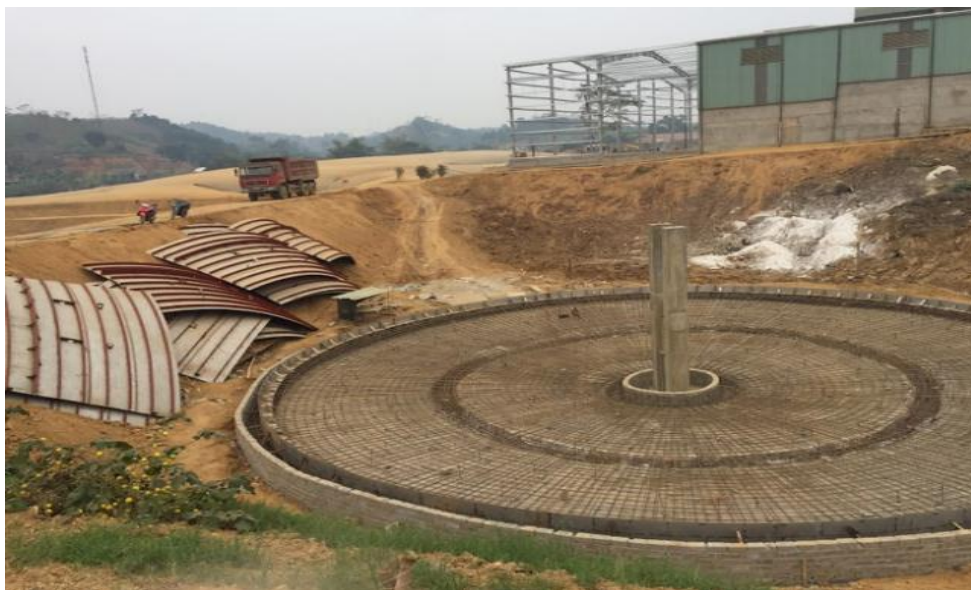
Hình 10: Bể lắng sinh học
